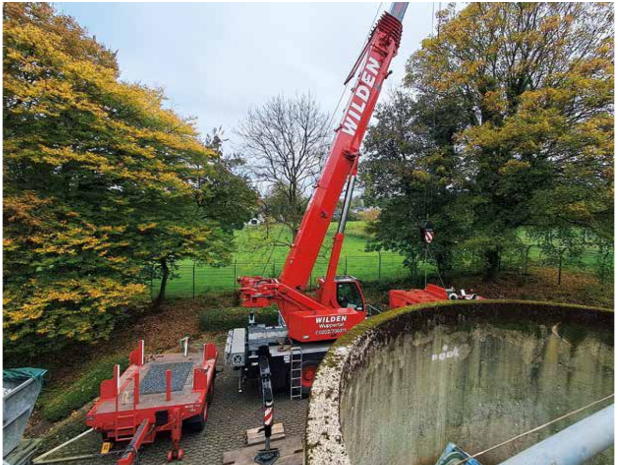
Austausch der Belüfterkerzen, KW Düssel
