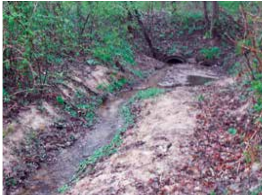
Verlandetes Gewässerprofil im Rückstau eines Durchlasses. Die Sohlanhebung ist an dem beinah komplett verlandeten Gewässerdurchlass gut zu erkennen.
