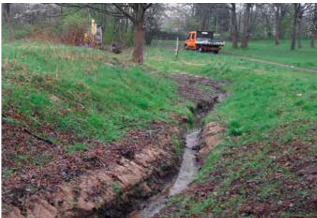
Das verlandete Gewässerprofil gegen die Fließrichtung fotografiert. Im Vordergrund sind jüngere, sandige und noch nicht begrünte Ablagerungen gut zu erkennen, die sich bei höheren Abflüssen und Wasserständen auf den Böschungen abgelagert haben und den Abflussquerschnitt einengen.
